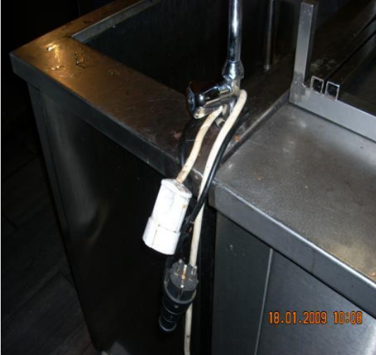
Yalıtılmamış Elektrik Donanımı
